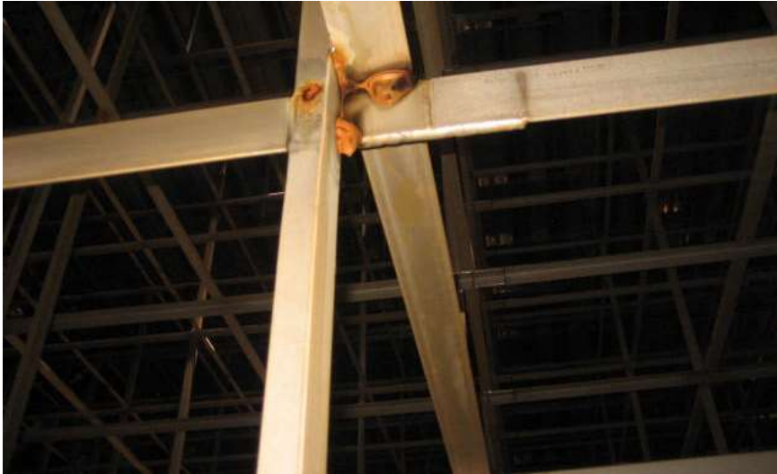
【内部補強材の腐食②】
