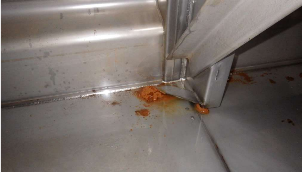
【底部補強材の腐食①】
