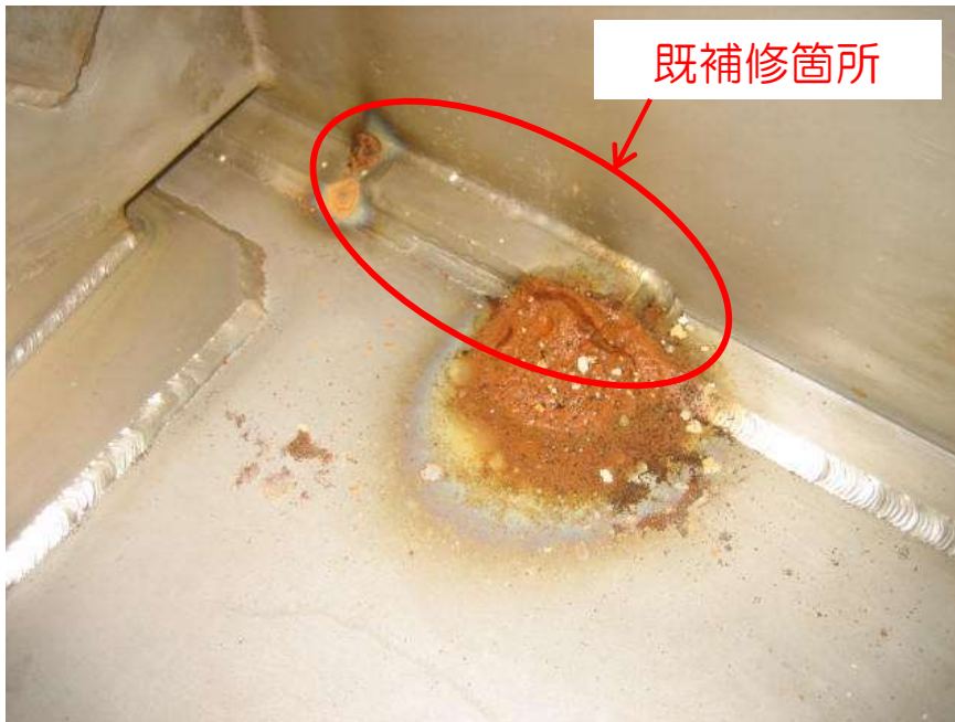
【既補修箇所の腐食】
