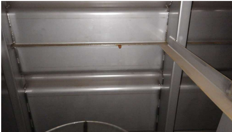
【内部補強材（水平方向）の腐食①】
