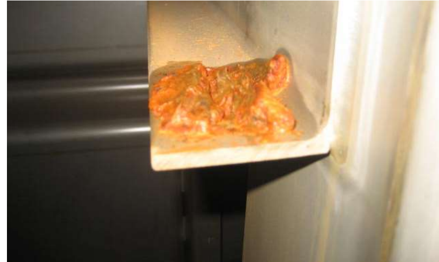
【内部補強材の腐食③】
