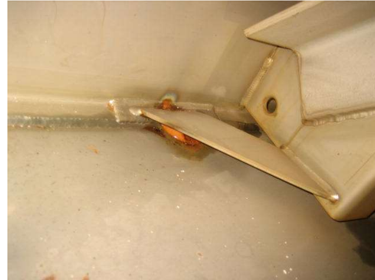
【底部補強材③の腐食】
