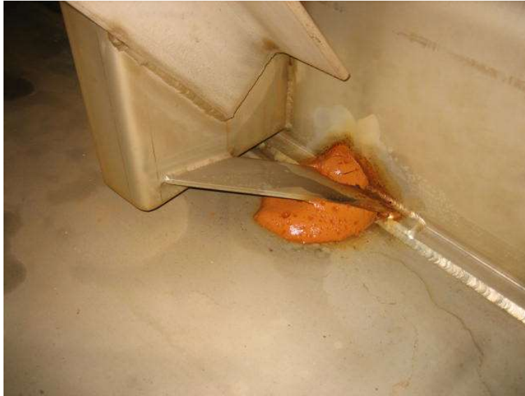
【底部補強材②の腐食】
