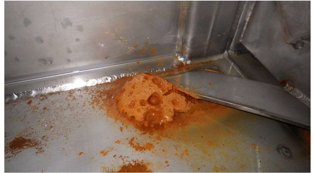
【底部補強材の腐食①（拡大）】
