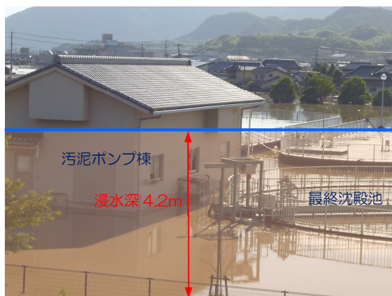
写真-2 処理施設の浸水状況
