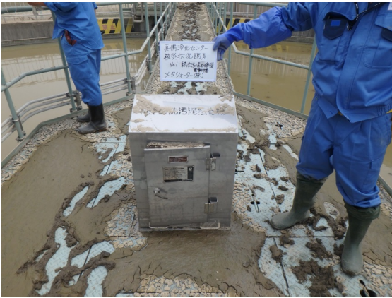
写真-4 最終沈殿池汚泥掻寄機
