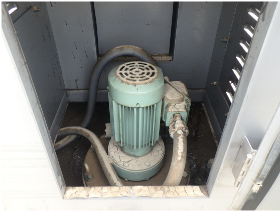
写真-5 汚泥掻寄機の駆動装置
