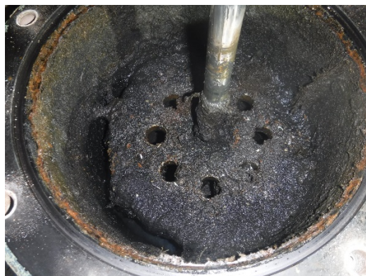
写真-7 逆洗ポンプの内部写真(砂の堆積)
