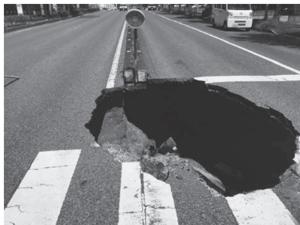
写真－3 下水道管の腐食に起因する道路陥没 令和元年（千葉市）
