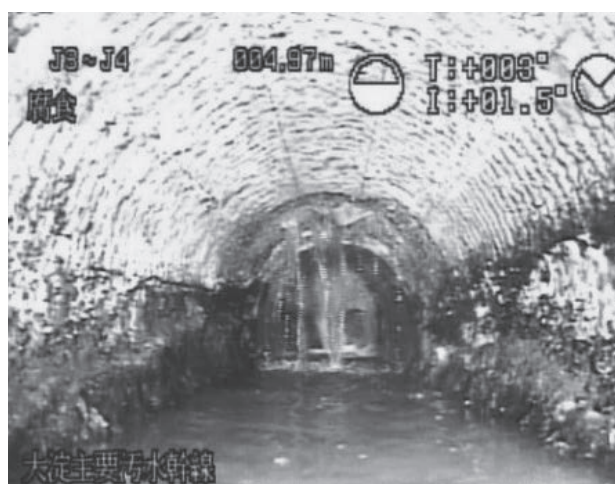
写真－4 硫化水素による管路の腐食 平成25年（宮崎市）
