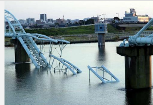
「和歌山市水管橋崩落時の様子」※
